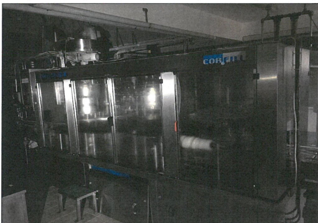
Fot.12. Widok ogólny nalewarka CORFIL. Źródło własne
