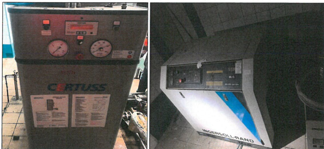
Fot.16. Widok ogólny instalacji technicznych. Źródło własne.
