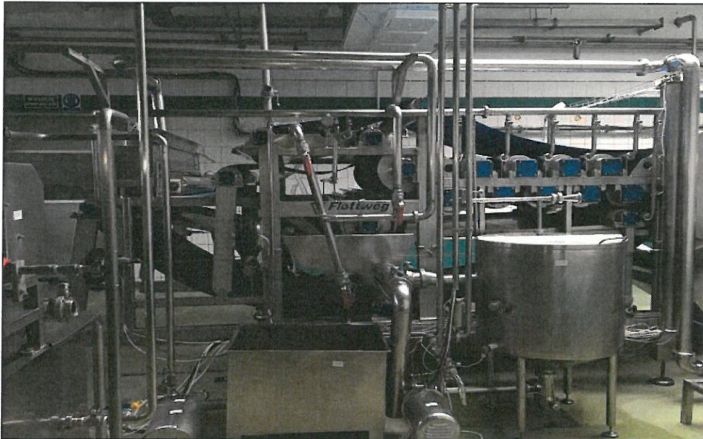
Fot.5. Widok ogólny filtru bębnowy. Źródło własne.
