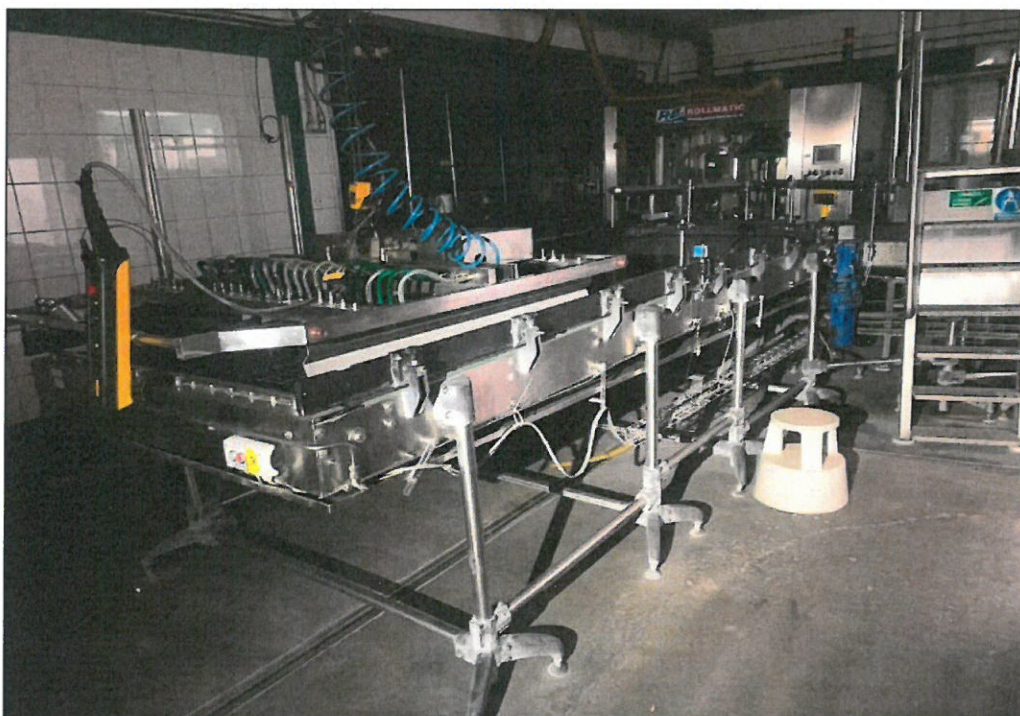
Fot.8. Widok ogólny depaletyzatora. Źródło własne.
